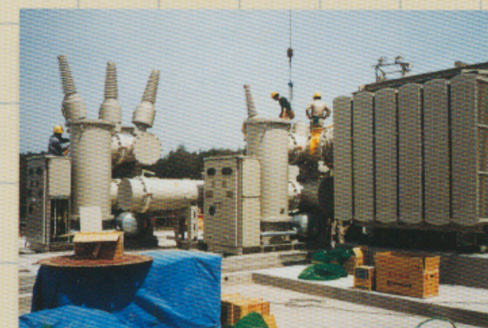
特高電気設備
