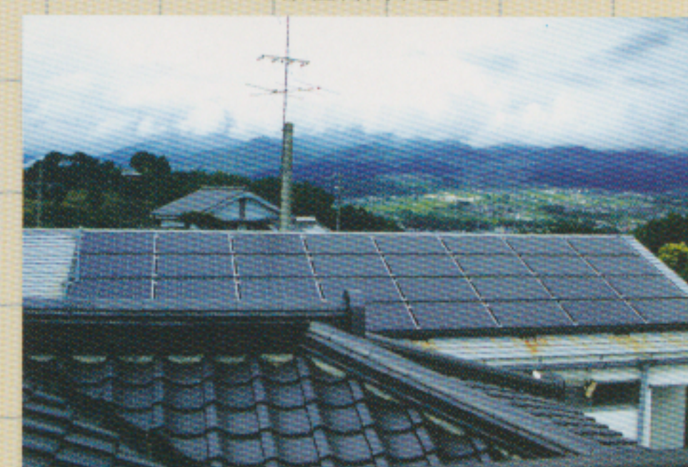
太陽光発電4kw 丸子町生田
